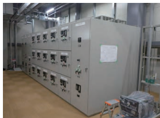
図5：高圧盤（電気室）
