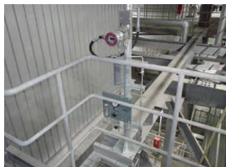
図8：現場計装機器
